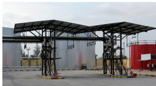
Погрузочная станция для 4 автоцистерн
