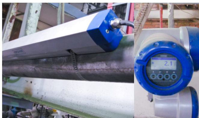
Накладной ультразвуковой расходомер OPTISONIC 6300 F на измерении расхода серной кислоты в трубопроводе Ду 100 на Челябинском цинковом заводе
